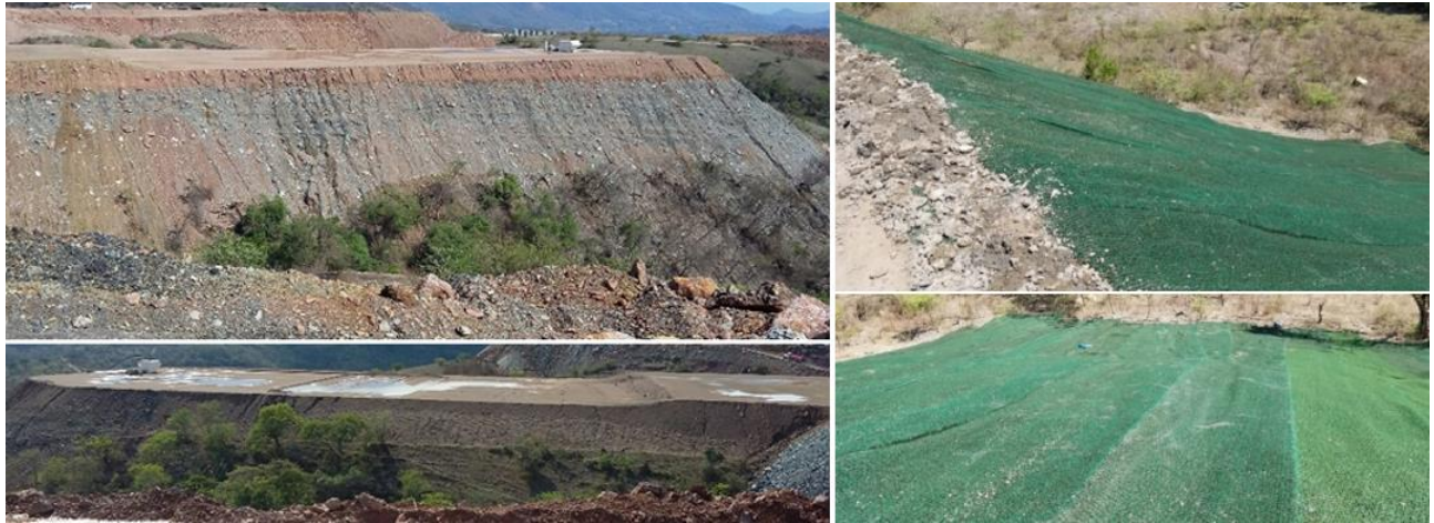
Figura 14. Taludes erosionados a la izquierda e instalación de la geomanta sobre el terraplén a la derecha (Capela).
